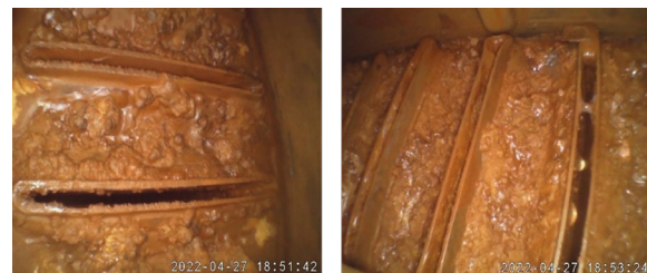
Figuras 2 e 3: Sedimentos de óxido dentro da tubagem dos radiadores
