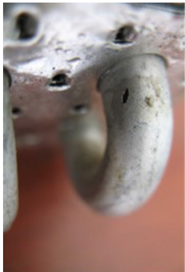
Trous de corrosion sur les tuyaux
