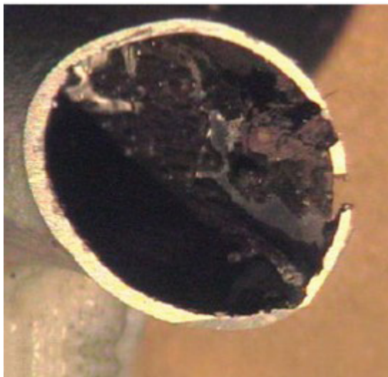
Particules de corrosion dans les tuyaux du chauffage
