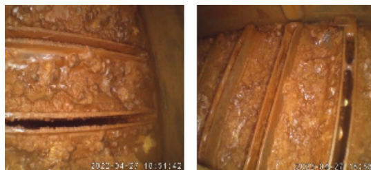
Photos 2 et 3 : sédiments de rouille à l'intérieur des tubes du radiateur
